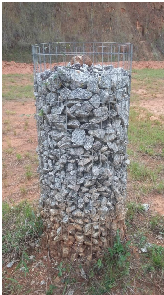
Figura 15: Dreno de gás
