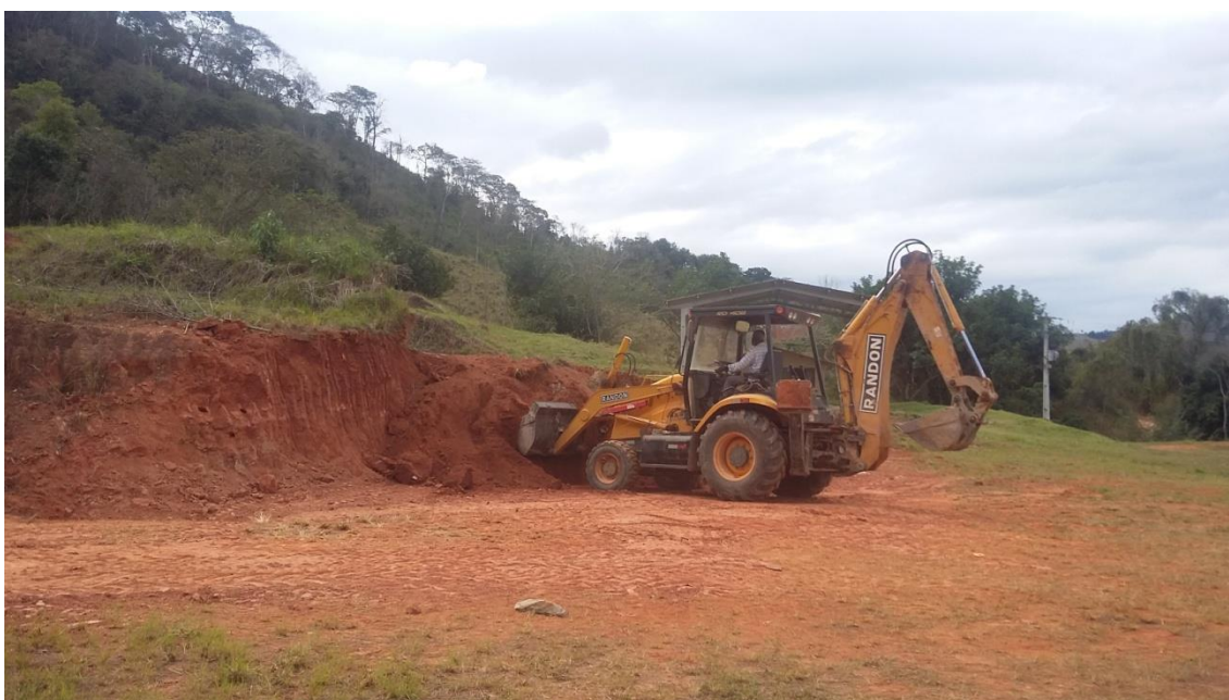
Figura 26: Área de empréstimo para retirada de material para recobrimento dos resíduos.
